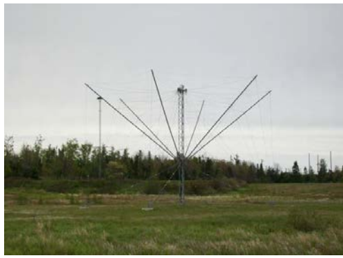
HF area antenna.
